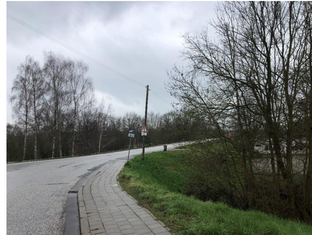
Abbildung 18: Wegesituation Schleusendamm / Kurfürstendeich (Quelle: eigene Aufnahme), keine Radverkehrsanlagen, Fahrbahnoberfläche mit Rissen, schlechter Zustand Gehweg.
