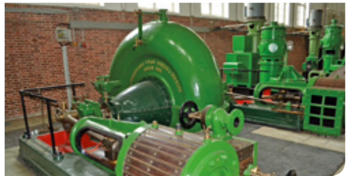
Abb. 3-3 (o.): Mittelgroße Pumpe (30 kW)
